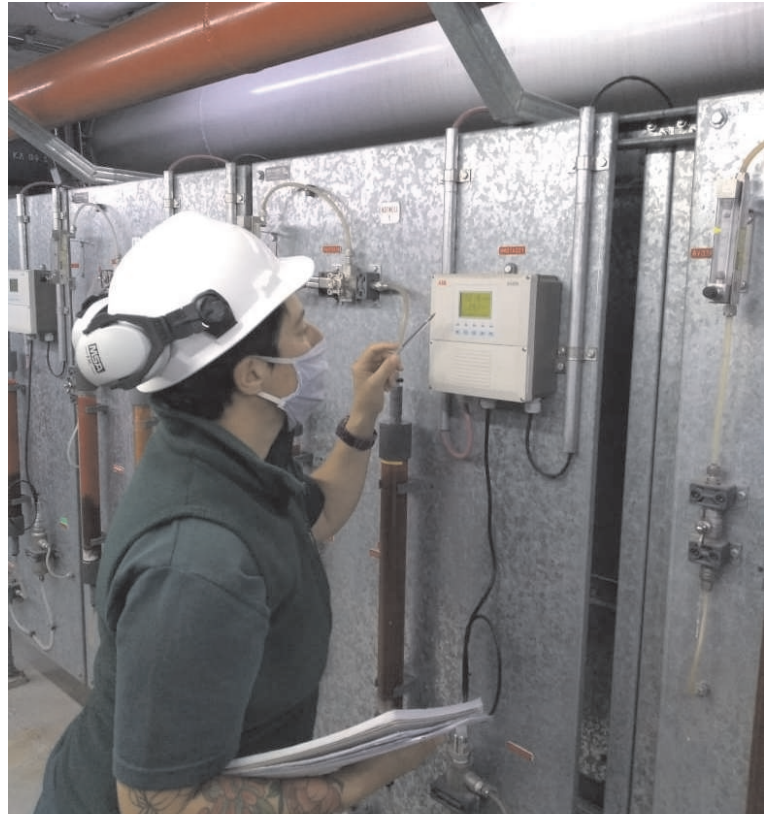
Verificación del funcionamiento de equipos de medición durante las recorridas rutinarias de la inspección residente de ARN en la Central Nuclear Atucha I
